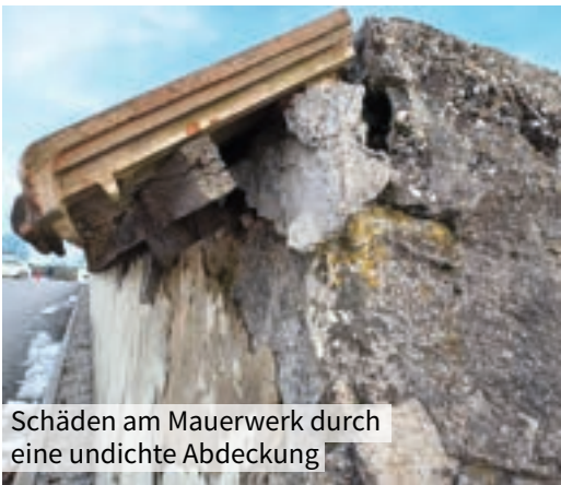
Das schadhafte Gesims beim Friedhofseingang wurde sicherheits- halber abgestützt.
